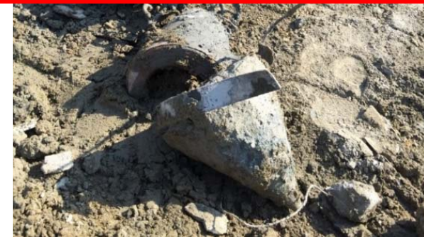
破損した既存杭
