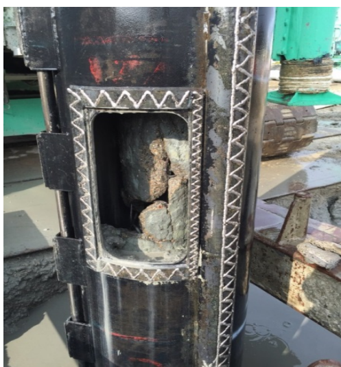
(折損している杭を内包した状態)
